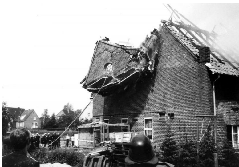
der Giebel musste aus Sicherheitsgründen heruntergezogen werden.
