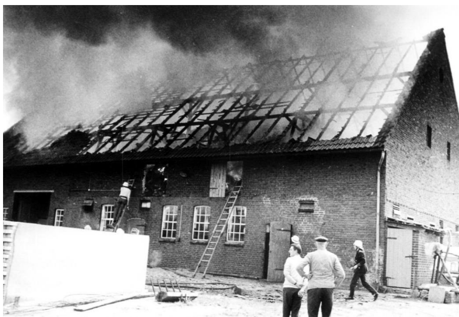
Das Feuer erstreckte sich über den gesamten Heuboden des Gebäudes
