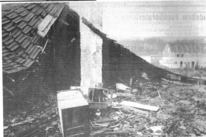
Dieser Dachstuhl im Brombeerweg wurde gestern von Beamten der Pinneberger Kriminalpolizei nach der Brandursache untersucht.
